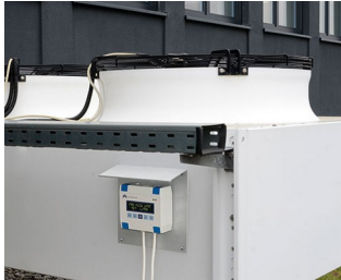
Commande de chauffage/climatisation/ventilation
