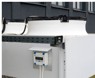
Commande de chauffage/climatisation/ventilation
