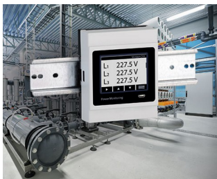
Surveillance des variables électriques
