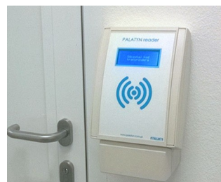
Lecteurs de contrôle d'accès
